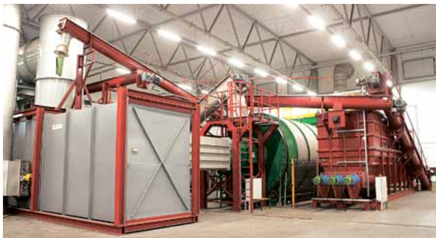
Цех по переработке помета. Линия сушки помета
